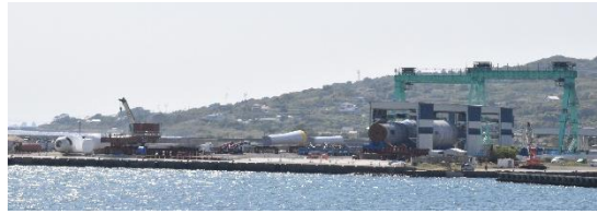
福江港では、洋上風力設備の建築が行われていました。離島で自然エネルギー発電を大規模に行い、本土に電気を売るという新産業が生まれるかもしれません。また奈留島では潮流発電の実証プラントが建築されていました。
